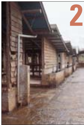
Canalización independiente de las aguas de lluvia, importante para reducir los volúmenes de purines.
